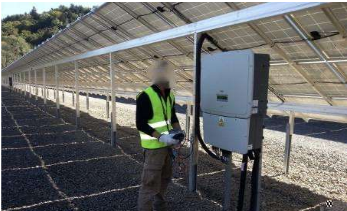
Fot. 3. Instalacja zamontowana pod konstrukcją paneli na jednej z pracujących w Polsce farm fotowoltaicznych w Tymbarku. Zdjęcie www.solgen.pl
