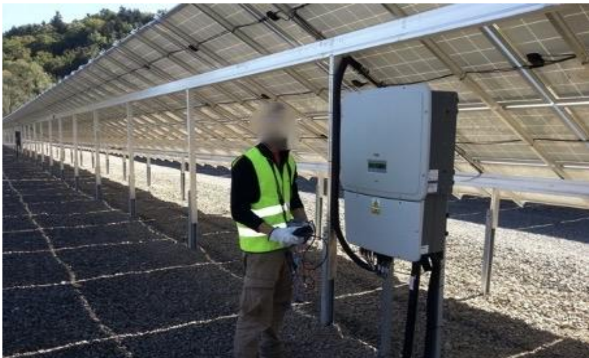
Fot. 3. Instalacja zamontowana pod konstrukcją paneli na jednej z pracujących w Polsce farm fotowoltaicznych w Tymbarku. Zdjęcie www.solgen.pl
