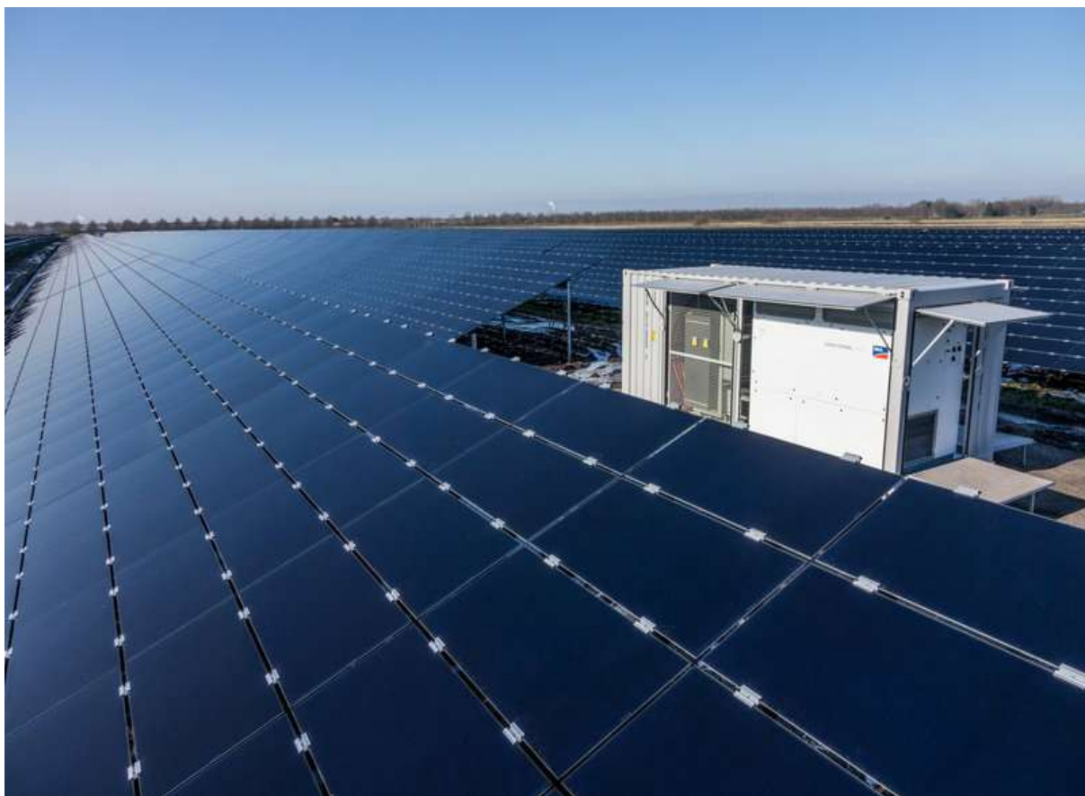
Fot. 4. Kontenerowa stacja rozdzielająca wraz z transformatorem. Zdjęcie www.belectric.com .
