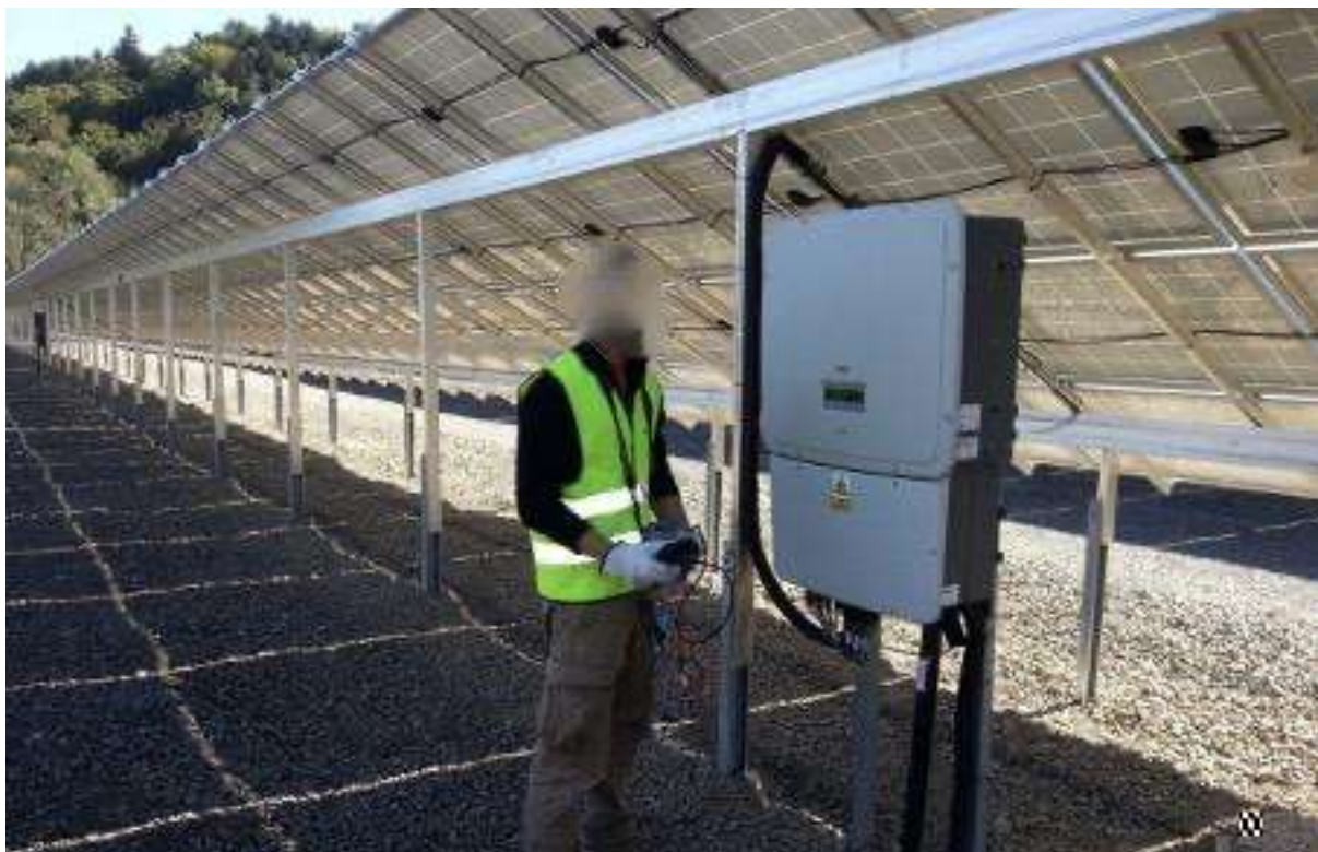
Fot. 3. Instalacja zamontowana pod konstrukcją paneli na jednej z pracujących w Polsce farm fotowoltaicznych w Tymbarku. Zdjęcie www.solgen.pl
